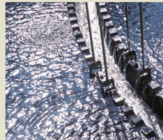
Partie de l'unité de traitement des eaux usées de Krefeld-Uerdingen
