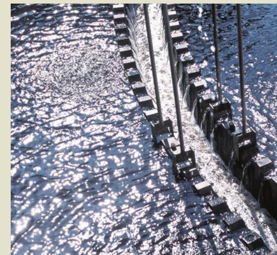
Particolare dell'impianto di trattamento acque di Krefeld-Uerdingen
